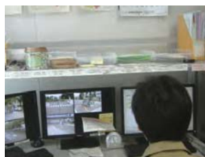
中央モニター監視室
