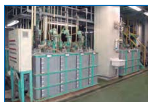
⑪ 環境保全センター (無機系廃液処理設備)
