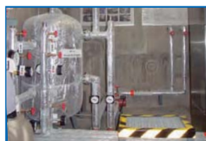
④ 地熱融雪設備
