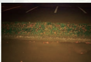
設置されたLED照明設備
