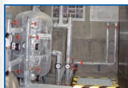
⑥ 地熱融雪設備
