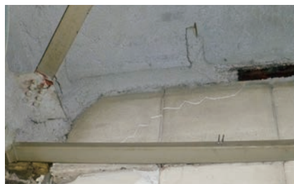
福利厚生会電気室(壁クラック)
