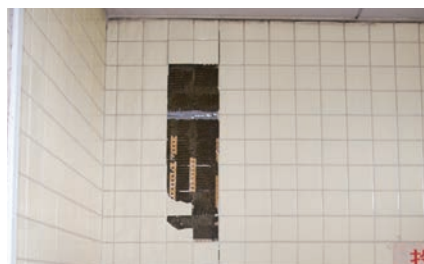
歯学部A棟(トイレタイル剥落)
