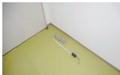
アイソトープ総合センター(コンクリート片落下)
