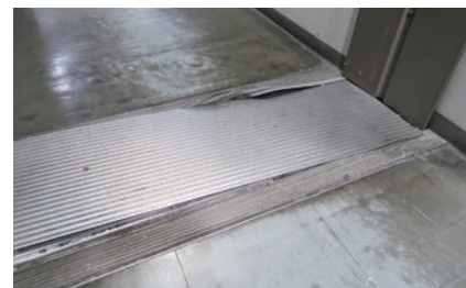
工学部材料化学研究棟(金物破損)
